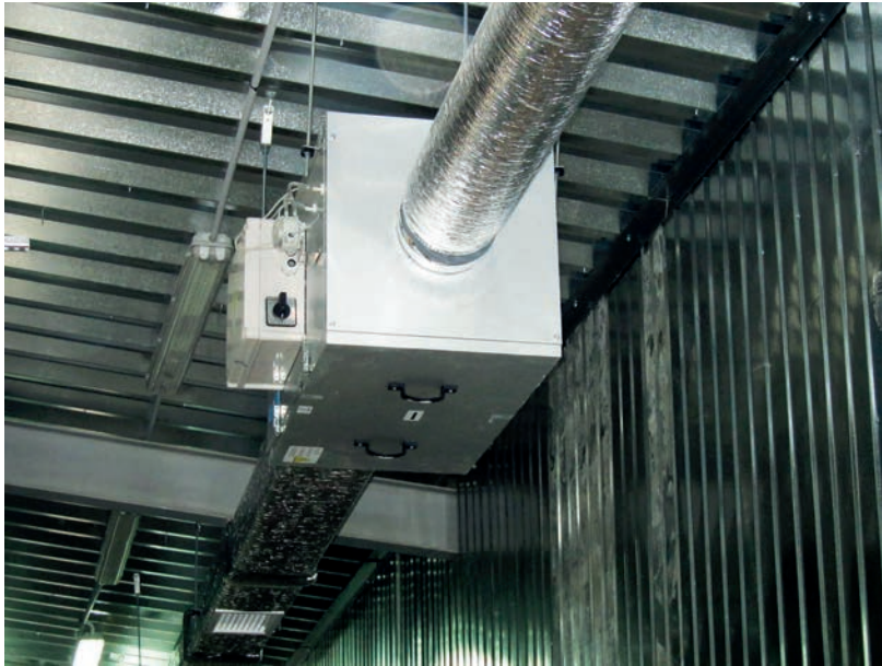
Рис. 55. Гнучкі гофровані металеві повітроводи.
