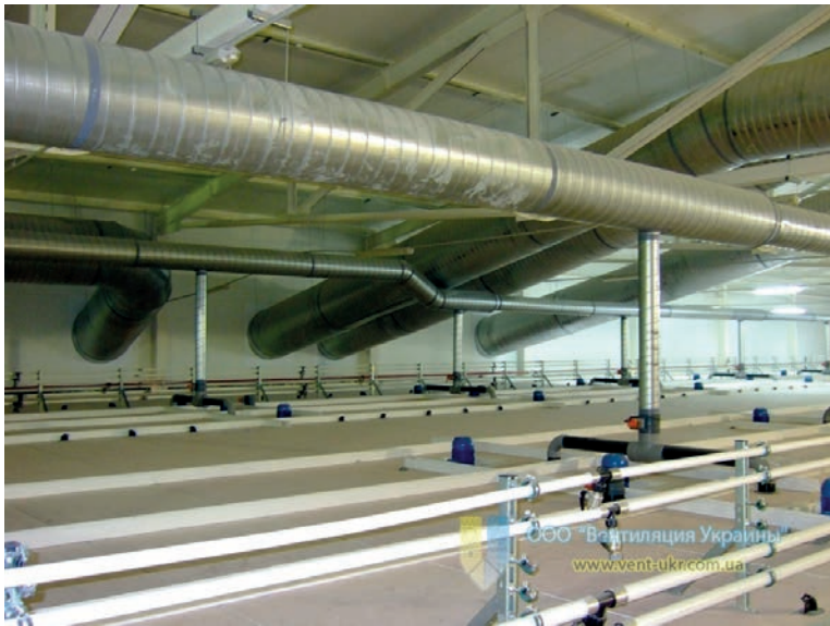
Рис. 54. Сталеві оцинковані повітроводи круглого перерізу
